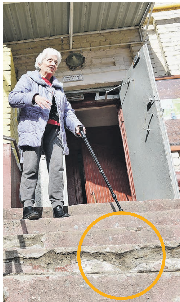
По мнению Галины Степановой, ступеньки у подъезда разваливаются из-за скопления воды
