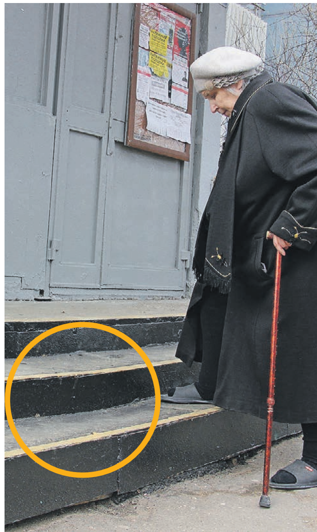
Ступеньки у входа в подъезд отремонтировали. Галина Михнюк теперь поднимается по ним без проблем
