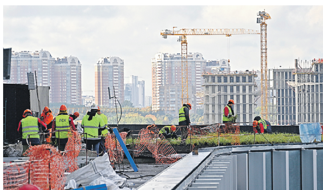
27 сентября 2022 года. На крыше образовательного кластера «Ломоносов» ведутся работы по ее озеленению. Здесь будет благоустроенная площадка для отдыха
