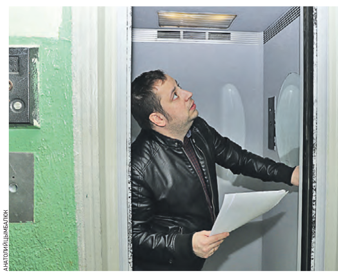
6 апреля 13:11 Представитель производственной компании Алексей Балыков проверяет лифт перед запуском
