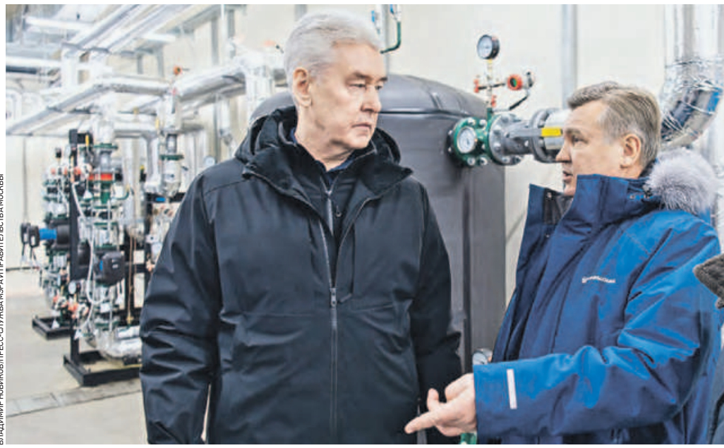
7 декабря. Мэр Москвы Сергей Собянин (слева) и гендиректор Мосводоканала Александр Пономаренко осматривают Люберецкие очистные сооружения
