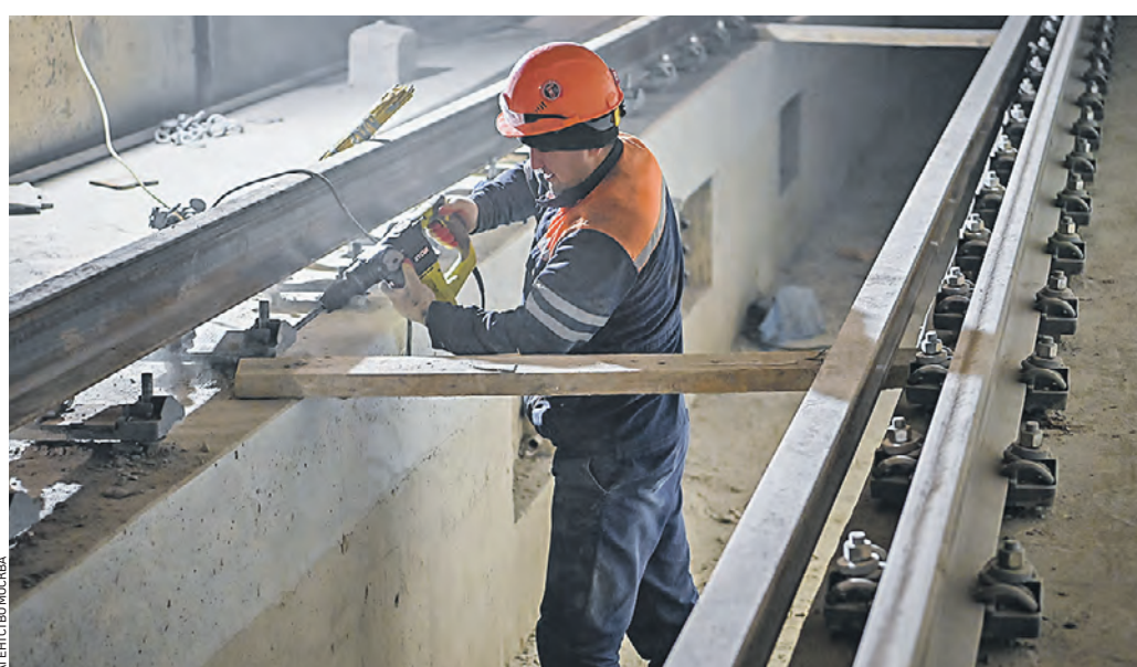
22 ноября. Строительство станции «Пятовская» Тройки линии метро. Помимо нее, в городе создают еще две линии — Бирюлевскую и Рублево-Архангелскую
