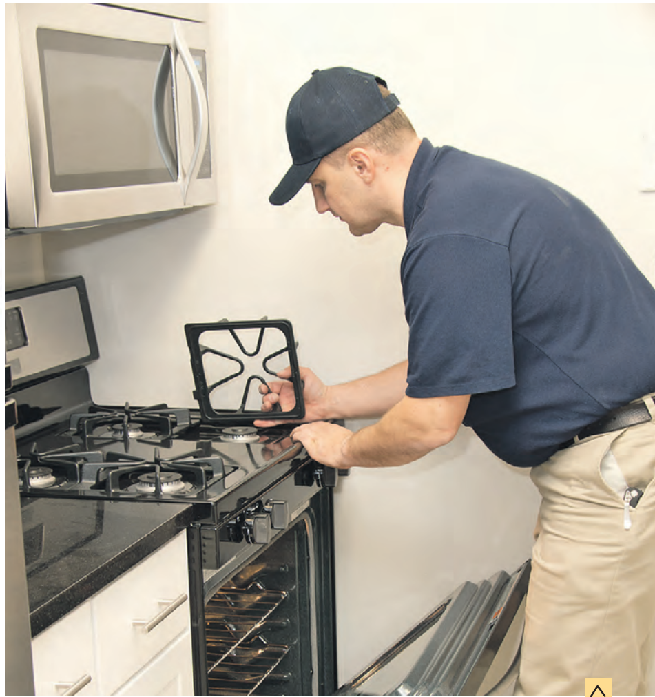
Замена газовой плиты на электрическую потребует участия специалистов различных служб
