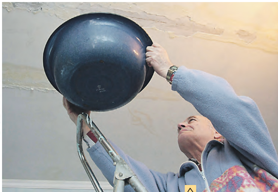
Последствия протечки кровли в жилом доме. Возместить ущерб обязан виновный в потопе
