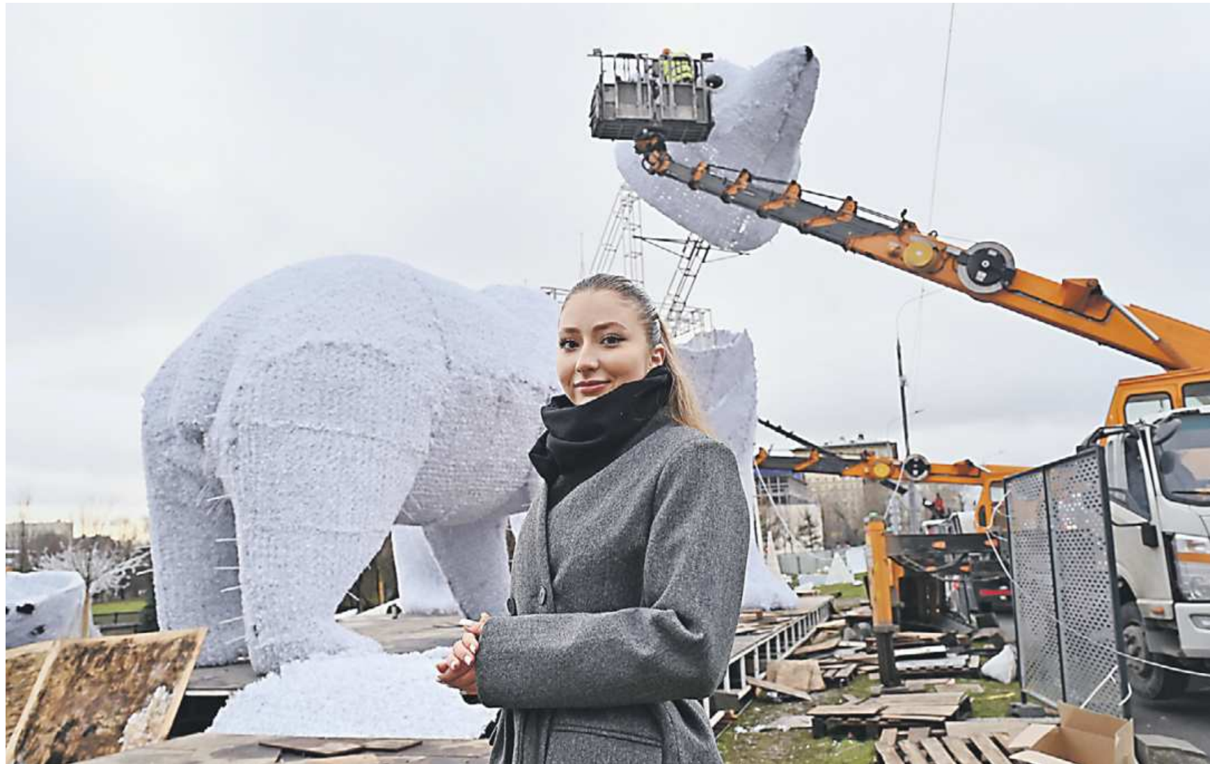
28 ноября. Специалист, занимающийся монтажом конструкции «Полярные медведи», Анна Ильина показывает, как идут работы. фото: АЛЕКСАНДР КОЧУБЕЙ
