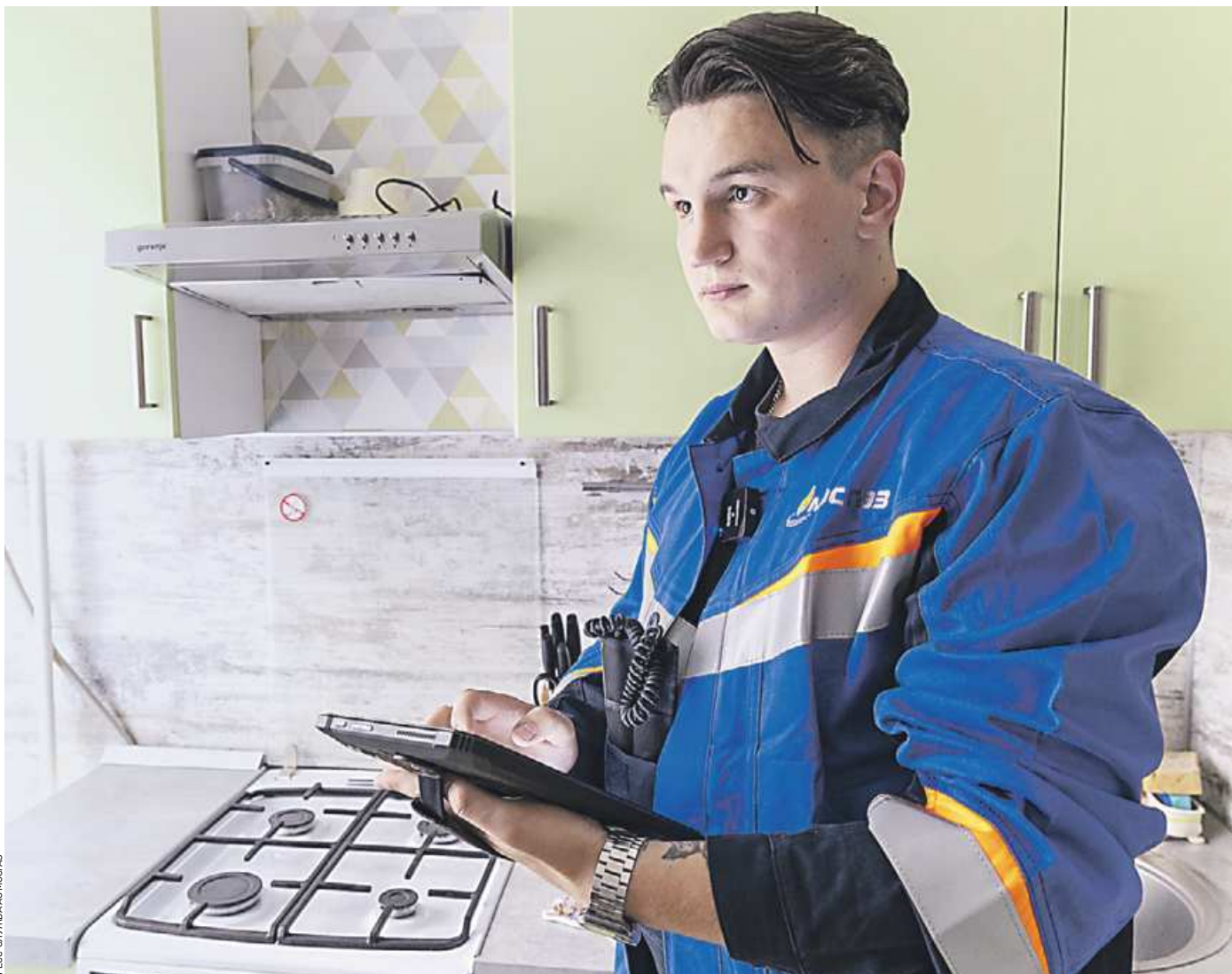
28 ноября. Слесарь по эксплуатации и ремонту газового оборудования АО «Мосгаз» Сергей Эпштейн проводит проверку газового оборудования в московской квартире
