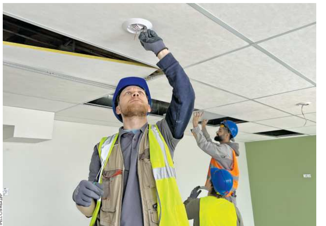
10 января. Сотрудник ремонтной бригады Александр Иванов занимается ремонтом потолка в рамках реконструкции школы № 2127 в районе Новоосино
