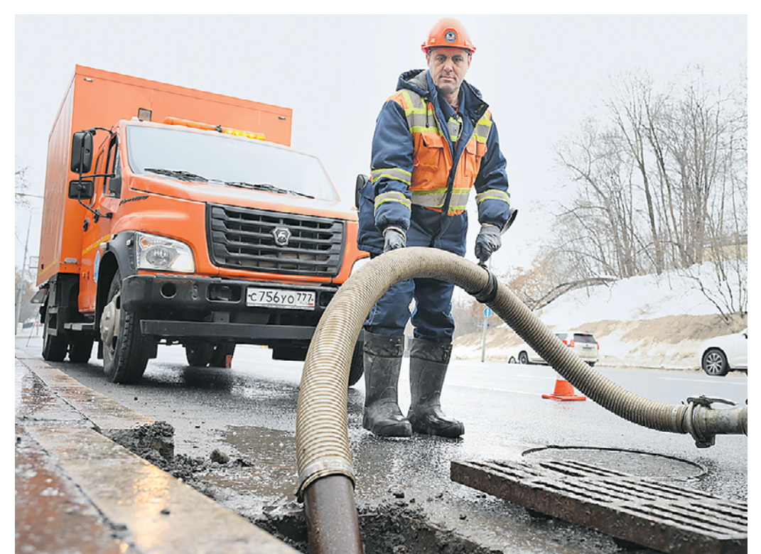
2 марта. Слесарь четвертого разряда Рамиль Фехретдинов занимается оттаиванием талого снега на Воробьевском шоссе. фото: пелагия заматина
